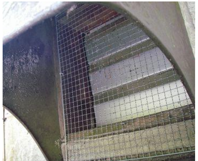
写真4 換気扇に金網を取り付けて封鎖成功
