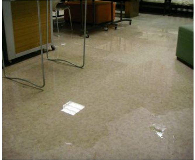
写真8 校舎の廊下に水が湧く
