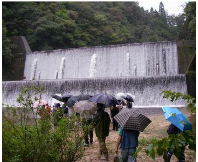
写真10 錦川支流宇佐川の大堰堤
