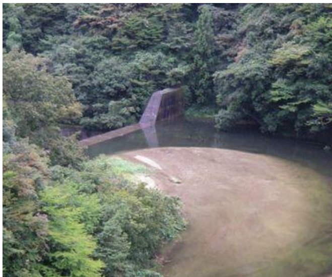
写真11 宇佐川堰堤上流側の堆砂
